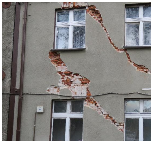
Rys. 3.20. Przykład uszkodzenia w budynku zakwalifikowanym do 3. kategorii uszkodzeń
