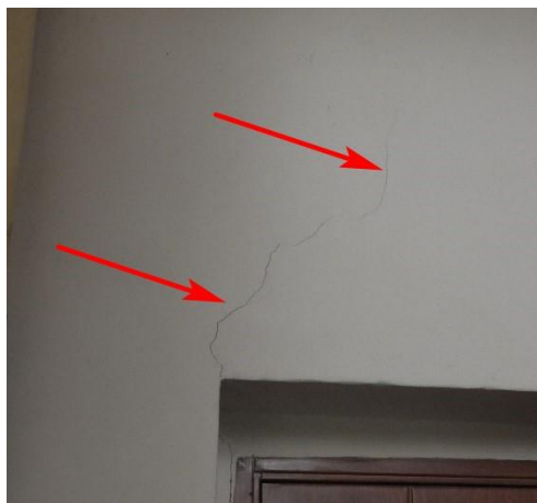
Rys. 3.18. Przykład uszkodzenia w budynku zakwalifikowanym do 1. kategorii uszkodzeń
