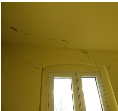
Rys. 3.19. Przykład uszkodzenia w budynku zakwalifikowanym do 2. kategorii uszkodzeń
