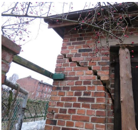
Rys. 3.21. Przykład uszkodzenia w budynku zakwalifikowanym do 4. kategorii uszkodzeń
